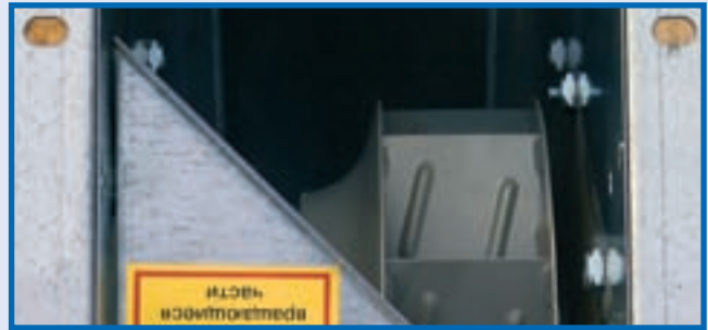
Рис. 2 Перемычка («язык») на выходе вентилятора GTLB
